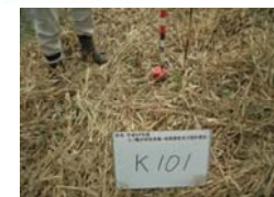
幅杭設置 建設用地の幅を示すため 計画路線に沿って両側に 杭を設置します。
