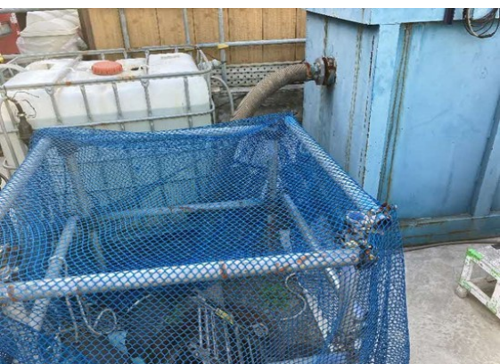
写真 4-1-5-11 下水道への排水
