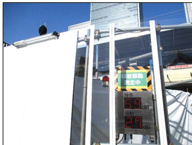
写真 2-1-1 (3) 常時計測・モニターの状況 (地点番号:03)
