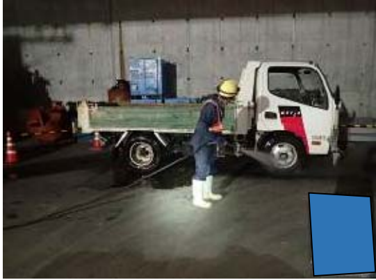
写真3-1-3-7 資材及び機械の運搬に用いる車両の出入口、周辺道路の清掃及び散水、タイヤの洗浄
