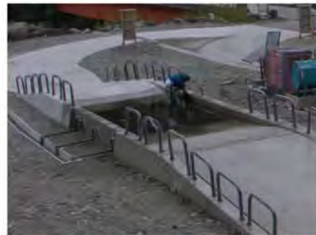
写真4 普通車用 洗浄プール
