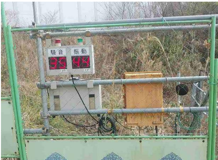
写真 参-3(13) モニター表示例 (08 南垣外非常口)
