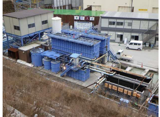
写真4-1-10-8 濁水処理設備の設置状況
