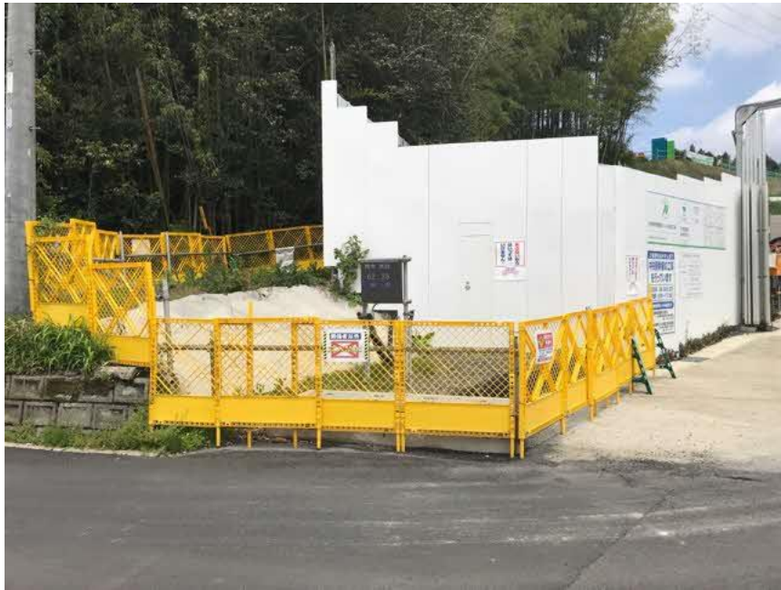
写真 参-3(8) モニター表示例 (05 駒場トンネル)
