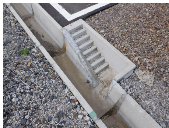
写真4-1-8-10 小動物等が脱出可能な スロープの設置状況
