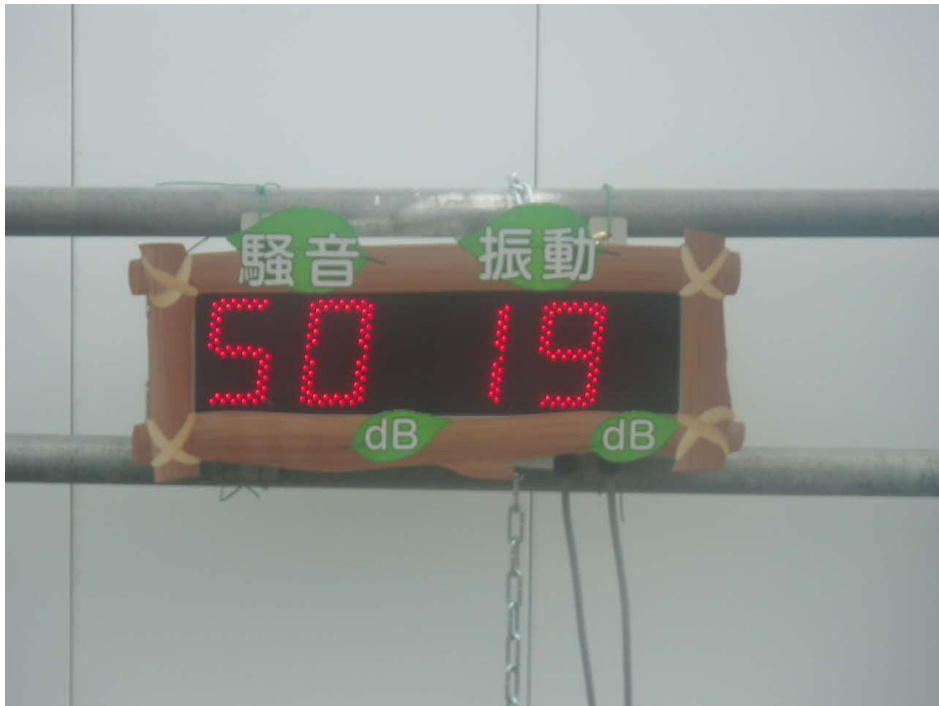
写真 参-3(4) モニター表示例 (02 瀬戸非常口)
