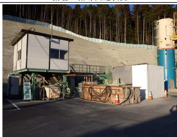
写真4-1-3-6 濁水処理設備の設置状況
