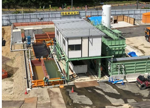
写真4-1-8-8 濁水処理設備の設置状況
