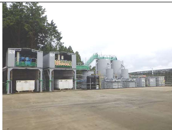
写真4-1-13-8 濁水処理設備の設置状況
