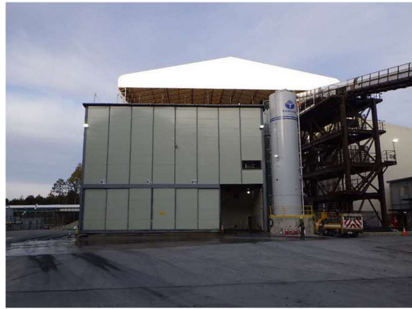
写真4-1-13-4 防音型建屋の設置状況
