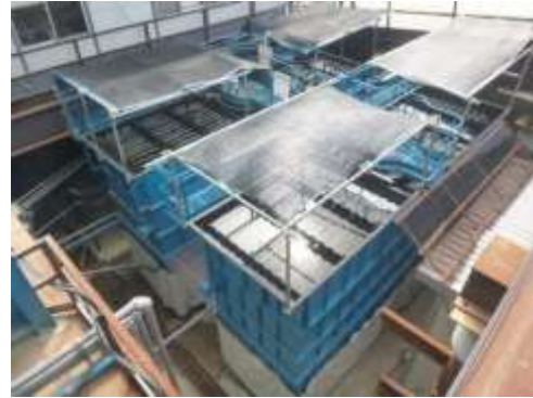
写真4-1-1-8 濁水処理設備の稼働状況
