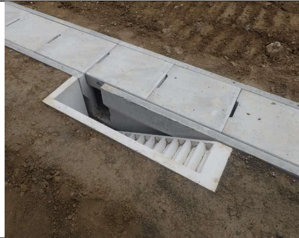
写真4-1-3-7 小動物等が脱出可能なスロープの設置状況
