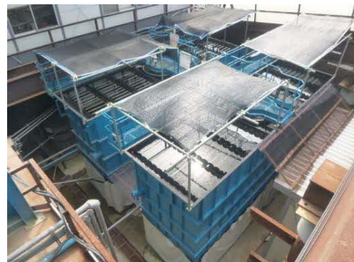
写真4-1-1-8 濁水処理設備の稼働状況
