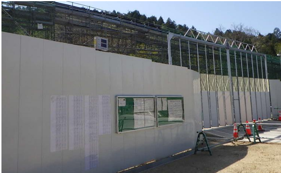
写真 参-2(8)-1 モニター表示例 (08 大針非常口)
