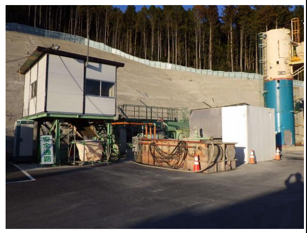
写真4-1-3-6 濁水処理設備の設置状況
