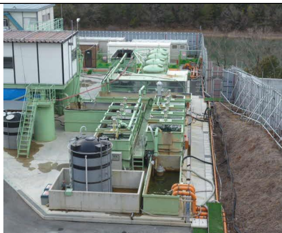
写真4-1-11-8 濁水処理設備設置状況
