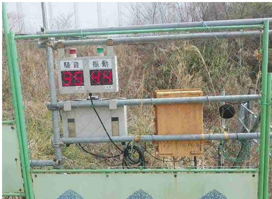
写真 参-2(6) モニター表示例 (06 南垣外非常口)
