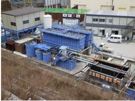
写真4-1-9-7 濁水処理設備の稼働状況
