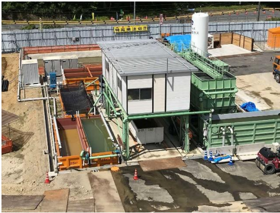
写真4-1-8-7 濁水処理設備の設置状況
