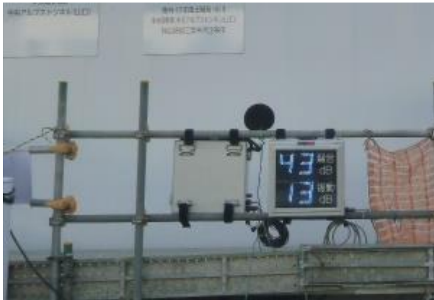
写真 参-2(1)-2 モニター表示例 (01 山口非常口)
