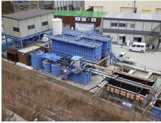
写真4-1-3-7 濁水処理設備の稼働状況
