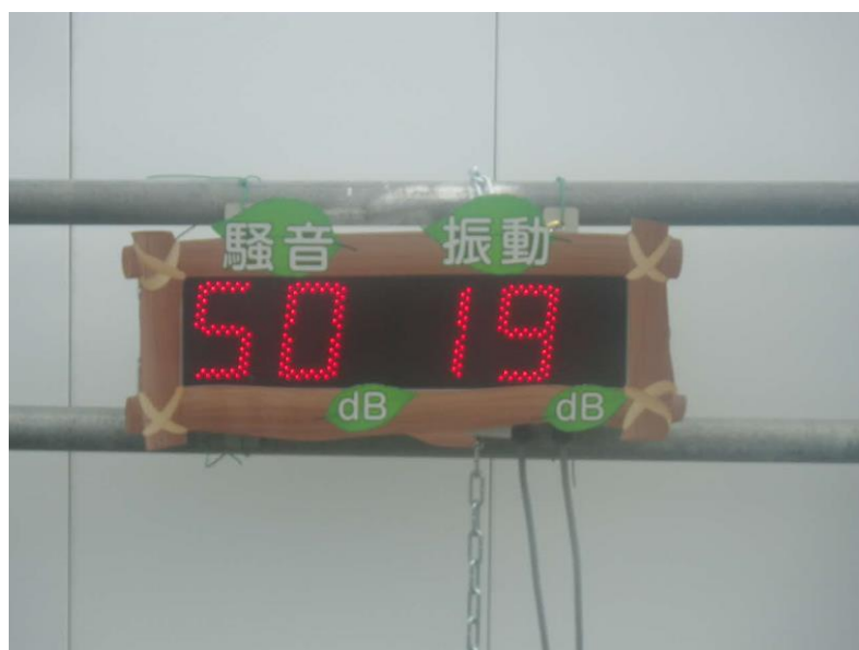
写真 参-2(2)-2 モニター表示例 (02 瀬戸非常口)
