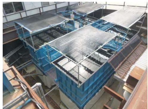
写真4-1-1-8 濁水処理設備の稼働状況
