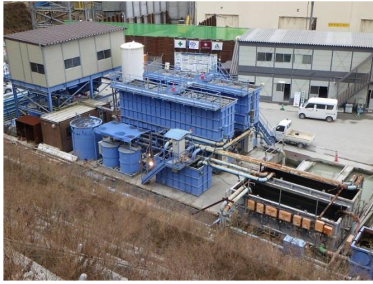
写真4-1-3-7 濁水処理設備の稼働状況
