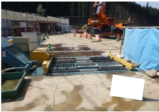
写真4-1-1-11 タイヤ洗浄機の設置状況
