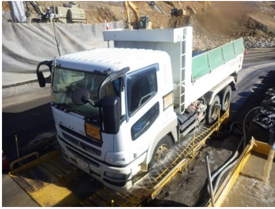
写真4-1-2-7 タイヤ洗浄機の設置状況
